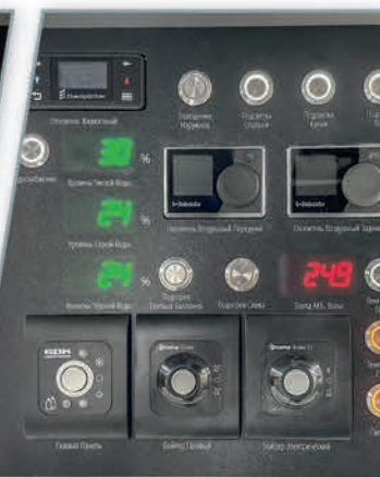
Пульт управления и мониторинга системами автодома
